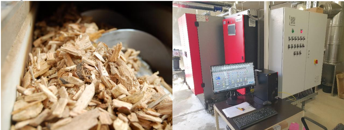
Abbildung 4: Hackschnitzelkessel. Quelle: UBP-consulting GmbH & Co. KG.
